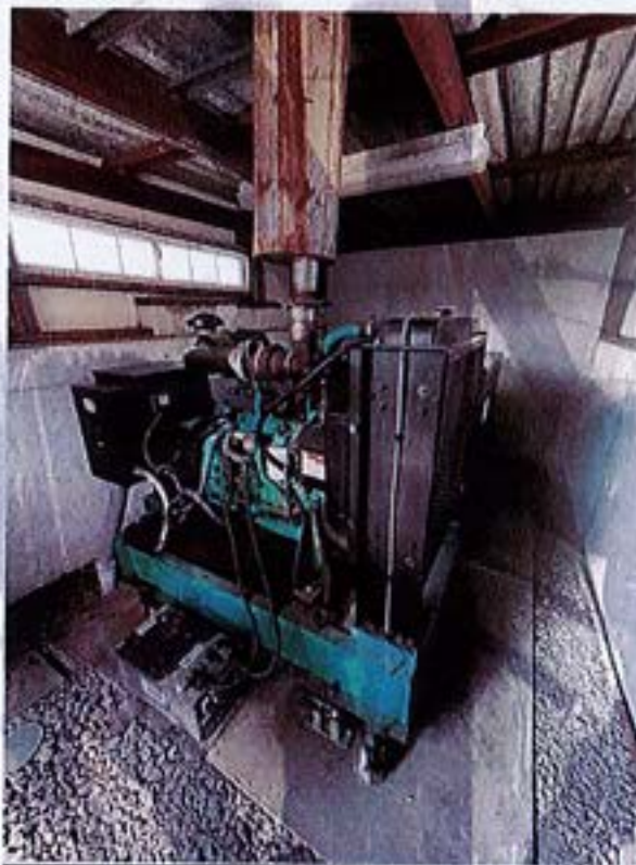
Fig. 5 Planta de Emergencia Trifásica de 80 KW, 220/127 Volts.
