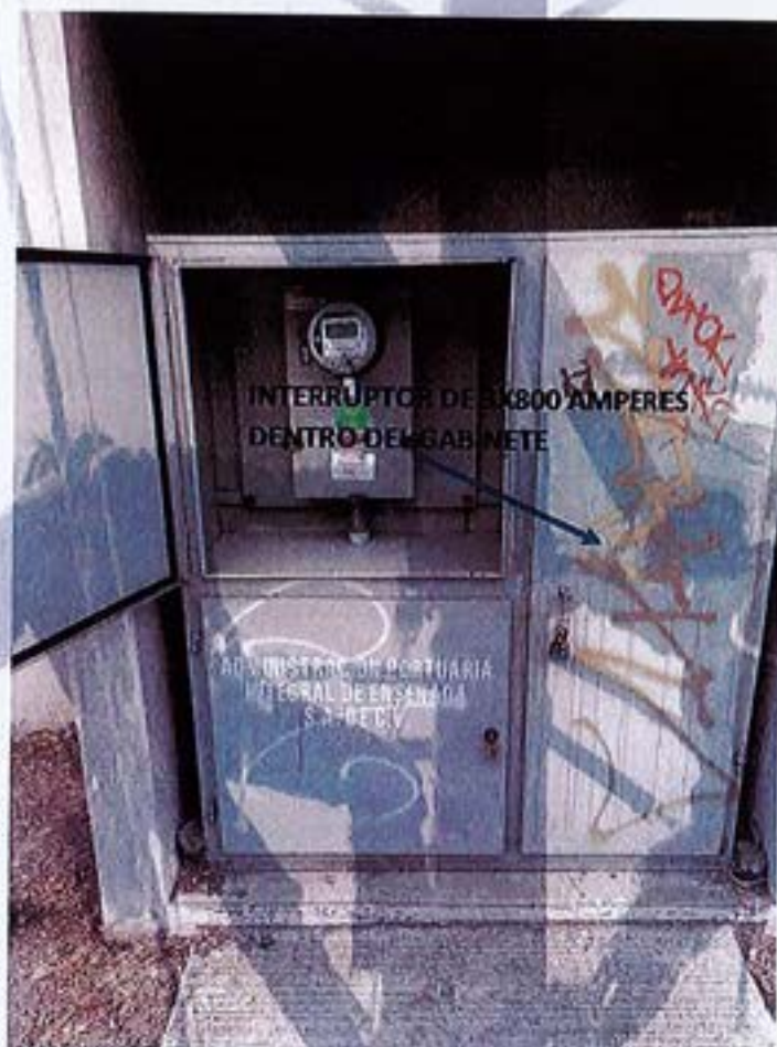
Fig. 3 Interruptor Principal de 3x800 Amperes
