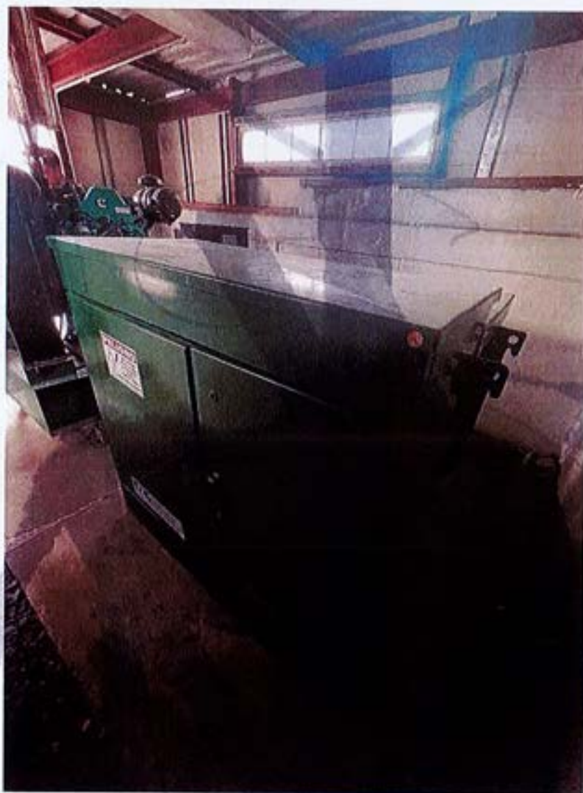
Fig. 2 Subestación Eléctrica Tipo Pedestal de 300 KVA, 13,200-220/127 Volts.
